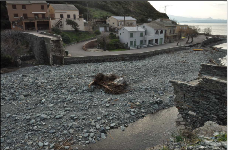
Photo du pont de Negru détruit, après l'accident du 23 novembre 2016 - © Atelier Arc - photo prise le 06 janvier 2017
