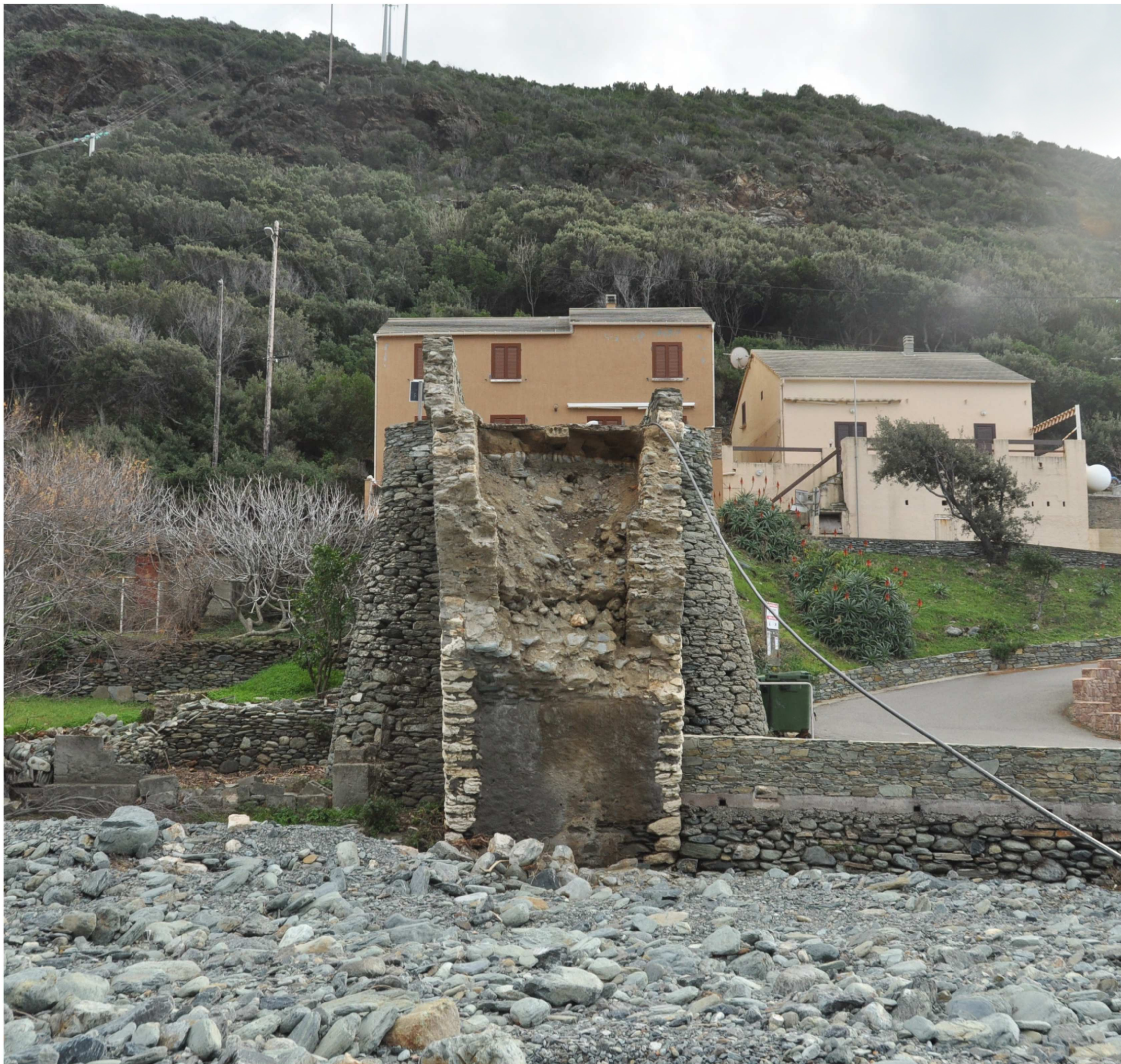
Maitrise d'oeuvre pour la reconstruction du pont génois de Negru sur la commune d'Olmata di Capocorso - Phase Diagnostic - réalisée par l'atelier ARC - www.atelier-arc.eu - remis le 07 septembre 2017
